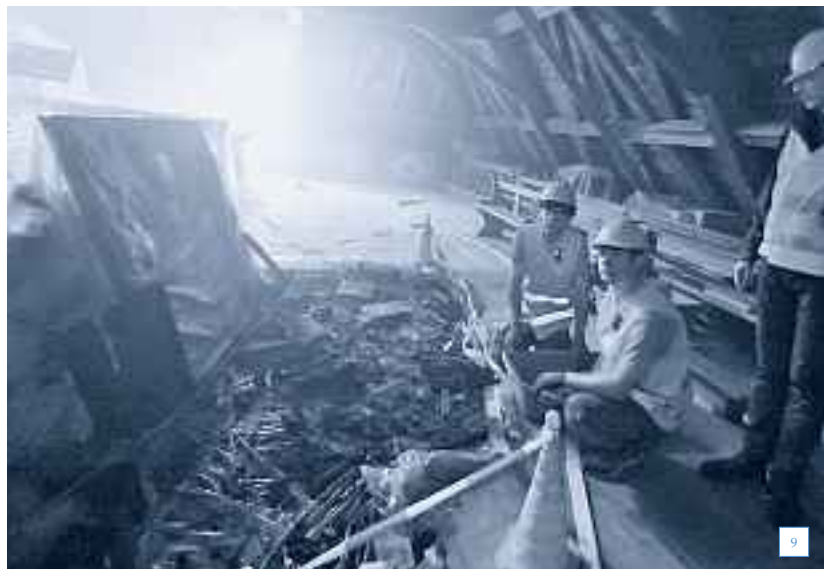
9 Auf Plastikbahnen ausgelegte Trümmerzonen mit Fragmenten zerstörter oder beschädigter Kulturgüter. Fotos: © CURESYS AG.
